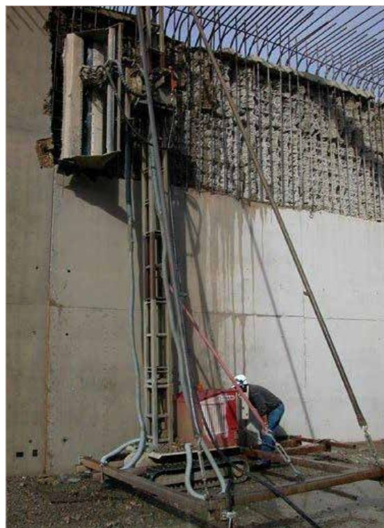
Hydrodémolition d'un mur. La structure présente sur la photo est destinée à équilibrer la poussée horizontale.
