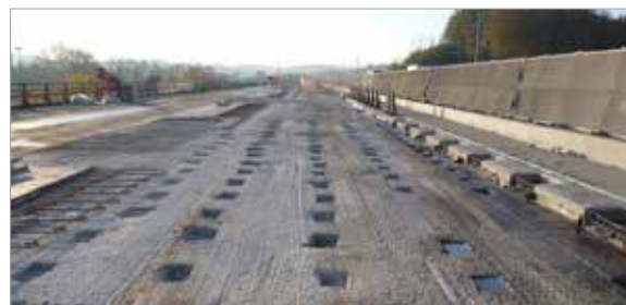
Des réservations ont été réalisées sur le hourdis du pont afin d'assurer la liaison avec le béton qui y sera rapporté.
